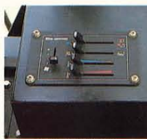
エアコン操作パネル
